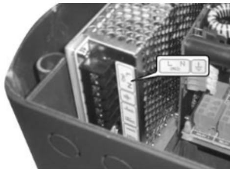
Figura 7 Conexión del suministro principal
